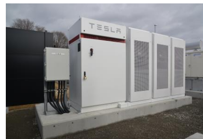
大容量蓄電池
